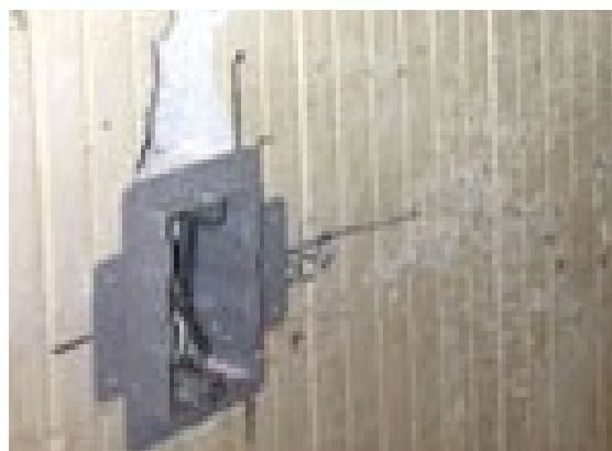
Plus de 700 boîtes électriques ont été installées dans ce nouvel hôtel pour les connexions électriques et de données
